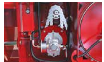
Der Pumpenantrieb erfolgt über einen Zahnradmultiplikator. Hinter der Pumpe ist ein Druckfilter angebracht, der für zusätzliche Sauberkeit des Öls im System sorgt.
